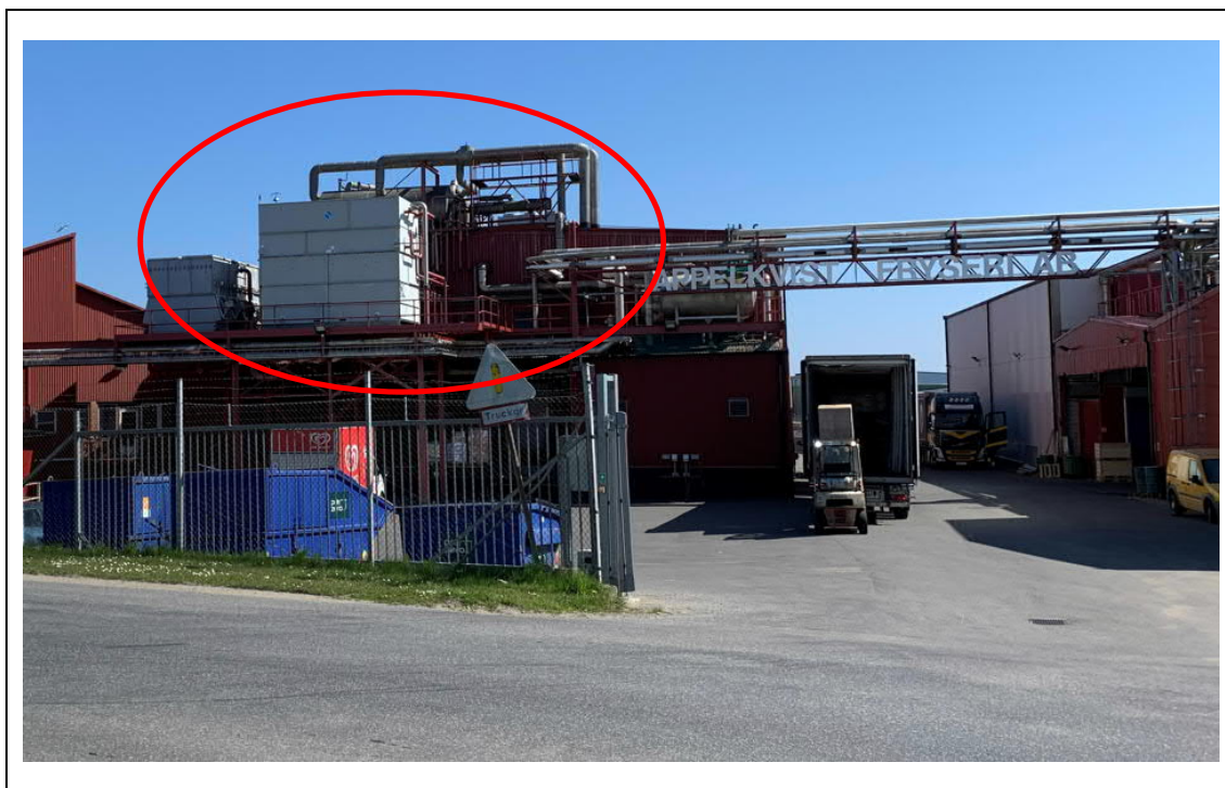
Figur 2. Kylmaskiner och kompressorer på Appelkvist Fryseri. Ljudeffekt=99,5 dBA
