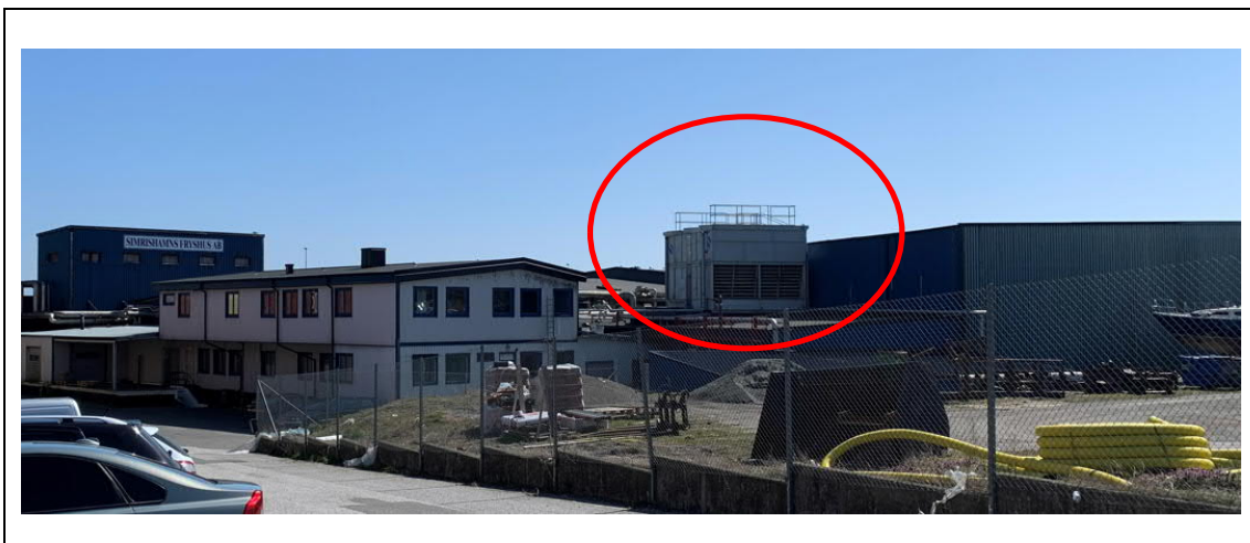
Figur 3. Kondensorer på Simrishamns fryshus. Ljudeffekt=104 dBA.
