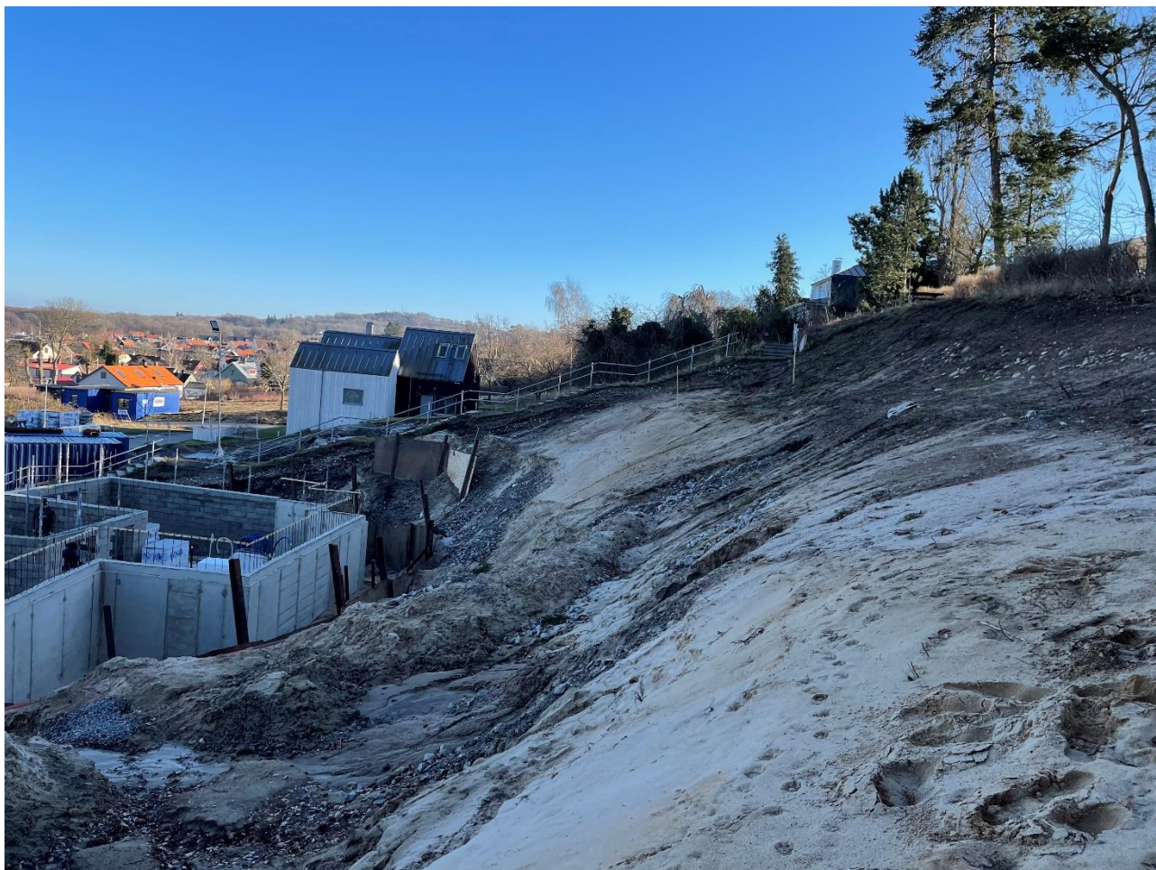
Figur 2. Bild över slänt samt sked som skett under byggnation.
